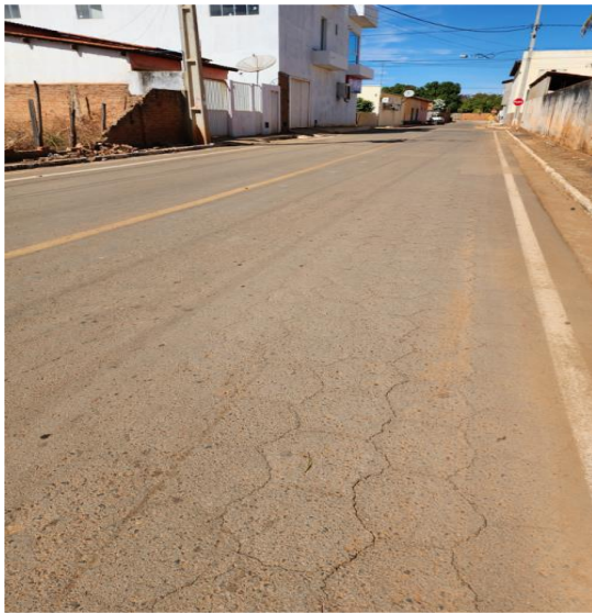
Figura 3: Trincas no pavimento executado em Cotegipe-BA
