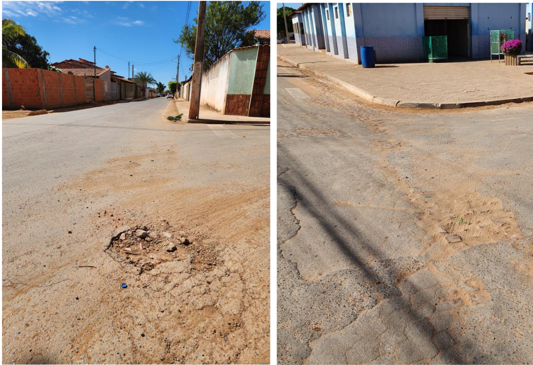
Figura 2: Patologias no pavimento executado em Cotegipe-BA
