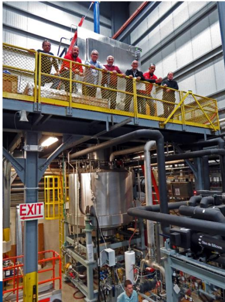
Condensador (em baixo) / Grupo de Bombas de Vácuo e Câmara frascos (em cima)
